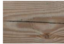
Spannungsrisse durch die Holz-trocknung
