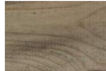
Umweltkeime, Stockflecken und leichter Schimmelbefall
