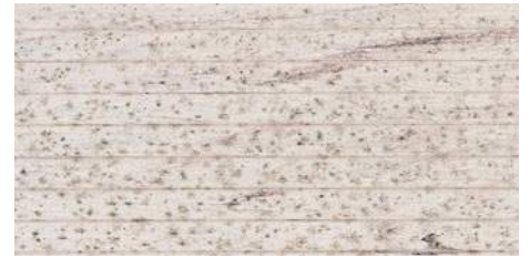
Stockflecken/Schimmel auf der Oberfläche
